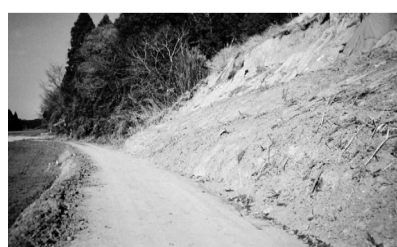
小間子町の崩落現場
