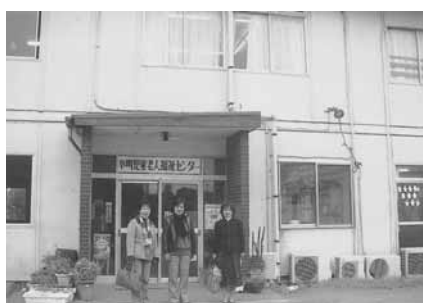
築40年 老朽化が進んでいる
