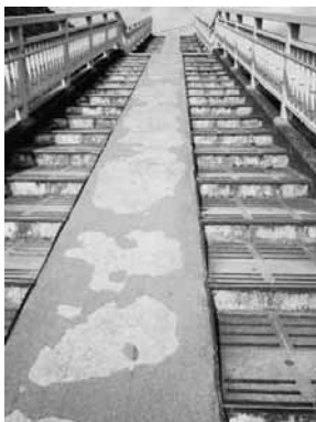
⑤幕張西・歩道橋の破損
