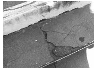
①幸町・歩道橋の破損
