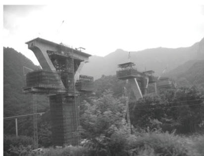
群馬県吾妻溪谷 ハツ場ダム予定地付近に建設中の道路の橋げた
